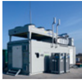
Haurup 1 MW Leistung, in Betrieb seit 2021
