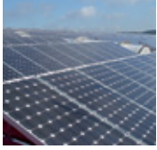
Dasing 1,5 MW Leistung, in Betrieb seit 2006
