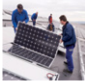
Neue Messe Stuttgart 3,8 MW Leistung, in Betrieb seit 2008
